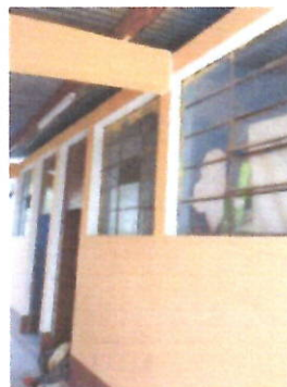
VENTANAS, SUSTITUCION DE VENTANAS, EN MAL ESTADO POR VENTANAS DE PVC
